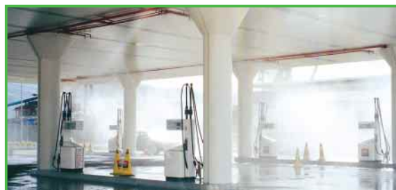
石油氣加氣站內的灑水器正在接受測試
