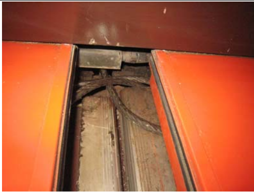
圖 1 - 在 24 樓升降機機廂門發現斷裂的懸吊纜索。
