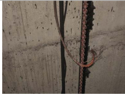
圖 2 - 升降機井道內發現斷裂的懸吊纜索。
