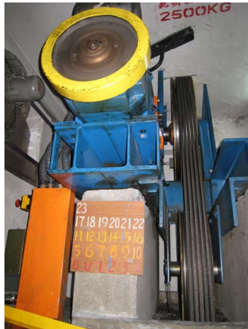
相片 4 - 2 號升降機機驅動沒有明顯損壞
