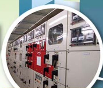
電力裝置 Electrical installation
