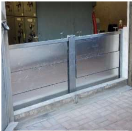
可拆卸防洪閘
