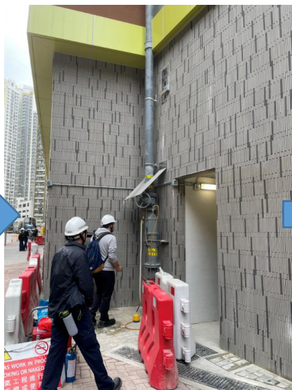
煤氣喉總掣及 主上升喉管
