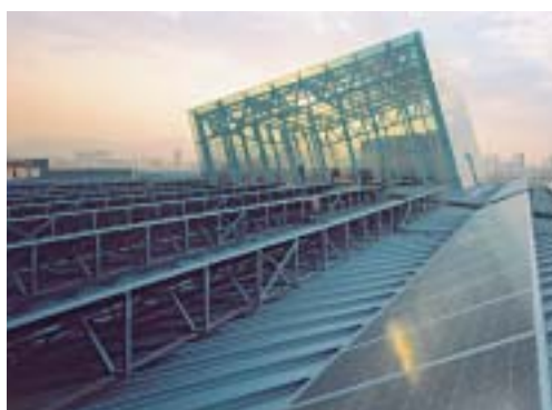
安裝於機電工程署新總部大樓天台的光伏裝置。
