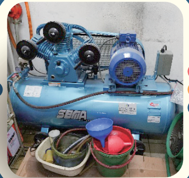
空氣壓縮機（風泵）
