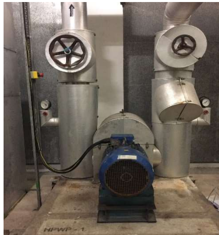
照片 A.11 冷凍水泵
