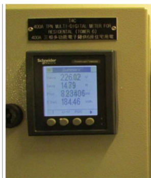
照片 A.12 400A 電路計量裝置
