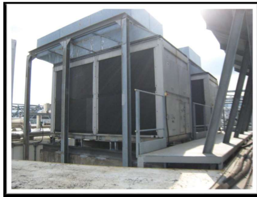
照片 A.10 風冷式冷水機
