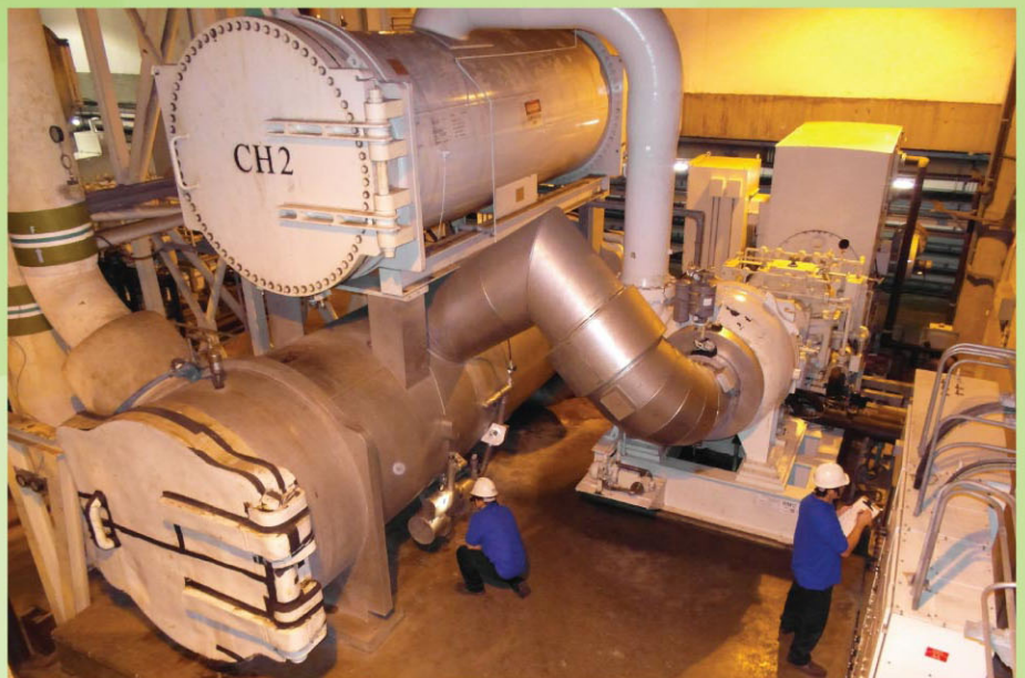
我們繼續為香港國際機場的空調系統提供操作及維修保養服務。圖為機電工程署員工於機場客運大樓的冷水機組機房進行檢查工作。
