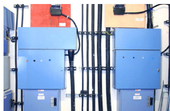
電力裝置 Electrical installation
