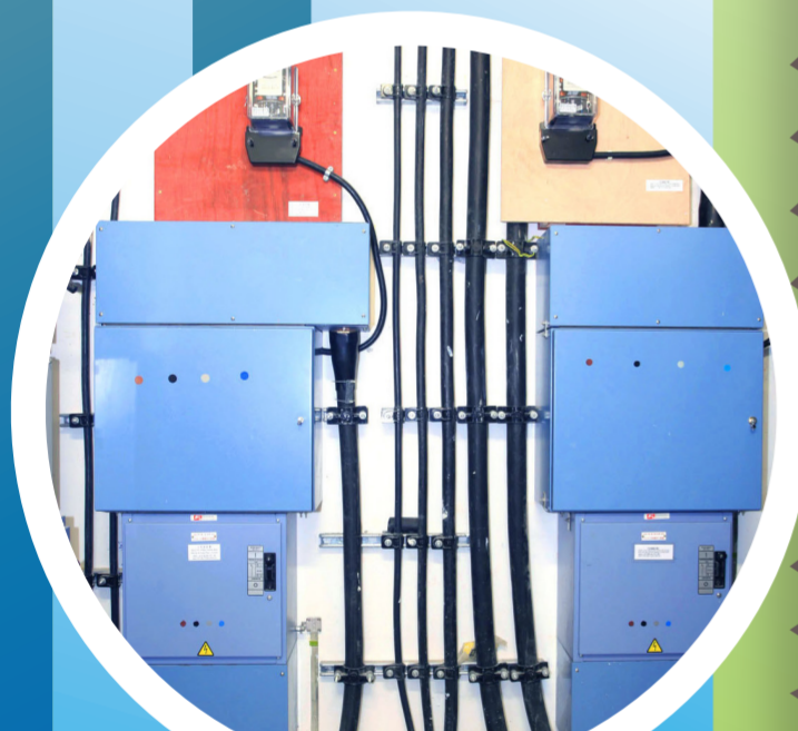
電力裝置 Electrical installation
