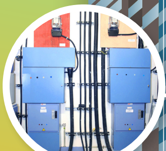
電力裝置 Electrical installation
