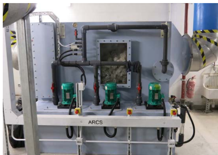
Figure 6.7 (d) : Venturi scrubber
