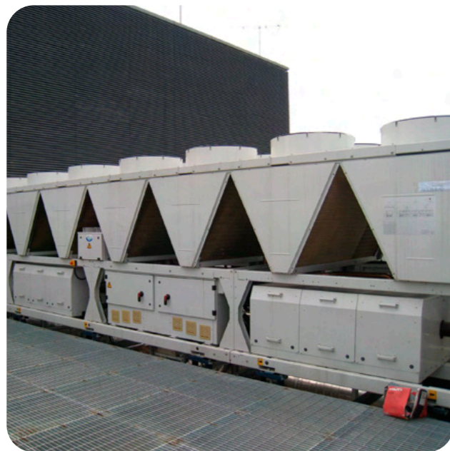
風冷冷水機組
