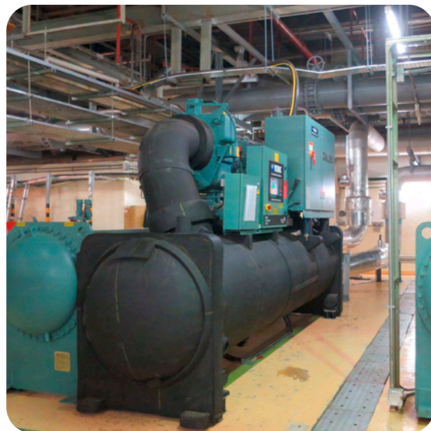
水冷式冷水機組
