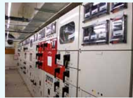
電力裝置 Electrical Installation
