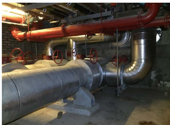
圖3：設備隧道內的網路接駁點 Photo 3: System interconnection in tunnel
