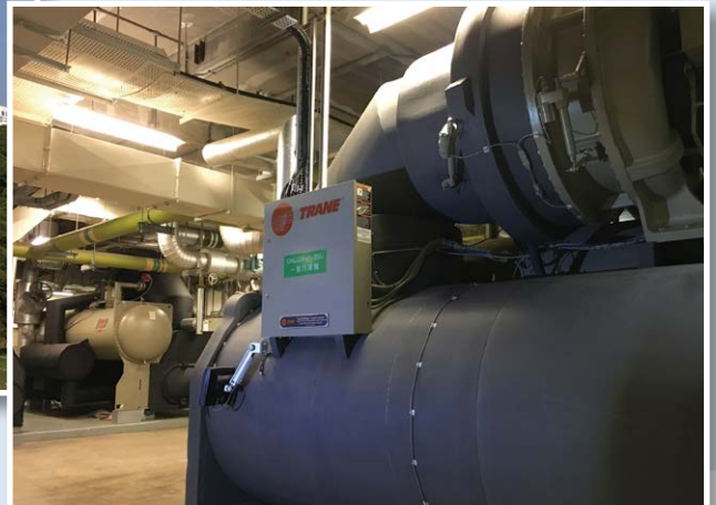
圖2： 新1,200冷噸製冷機 Photo 2: The new 1,200 RT chiller
