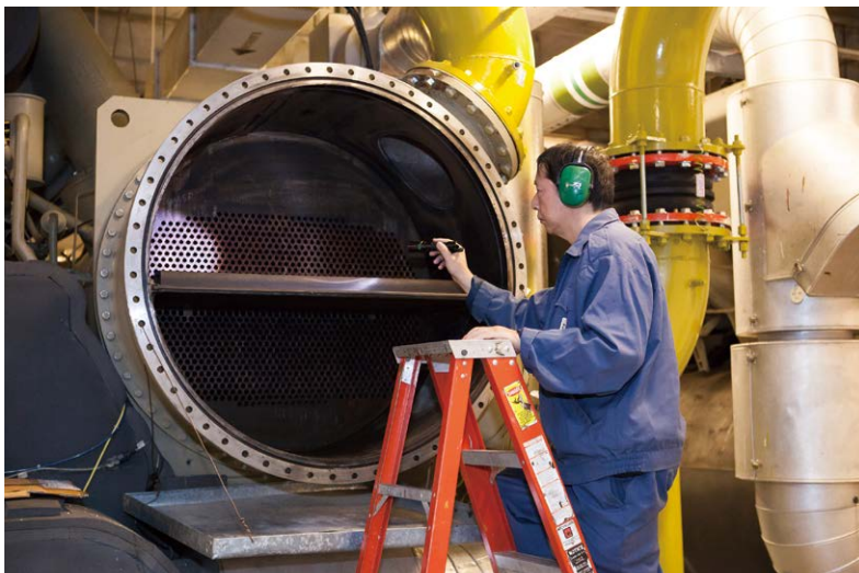
圖7：員工檢查中央製冷機
