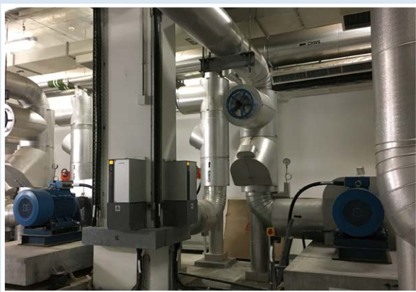
圖4：用戶支站的大樓加壓泵 Photo 4: User station pump
