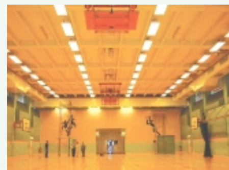
圖 2：高輸出T5管照明系統 Fig. 2: Lighting system using high-output T5 lamps
