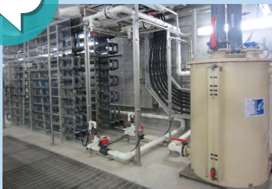
海水泵房內的電解產氯裝置。
