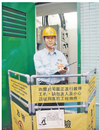
陸文祥表示，每次開工作前定必重複檢查，看有否做足事前的準備工作。
