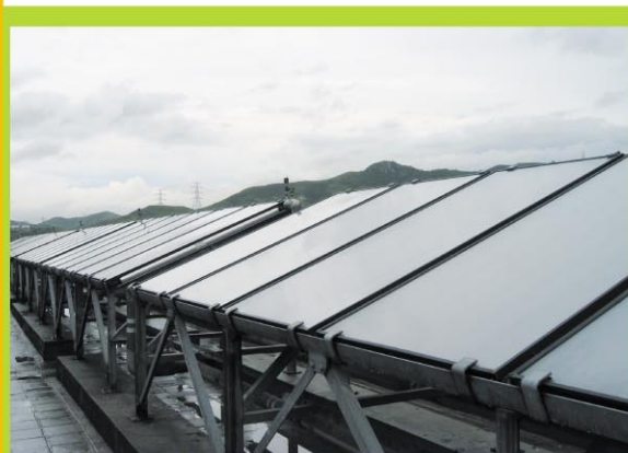
平板型集熱器 Flat-plate Collector
