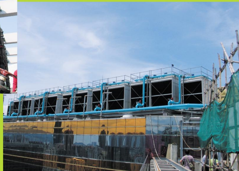
九龍旺角始創中心 (冷卻塔散熱量：15,300千瓦) Pioneer Centre at Mongkok, Kowloon (Heat Rejection Capacity: 15,300 kW)
