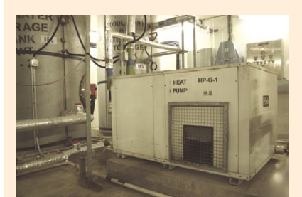
熱泵熱水器 Heat pump water heater
