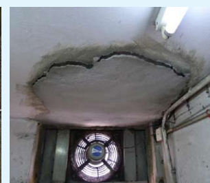
升降機機房有石屎剝落
