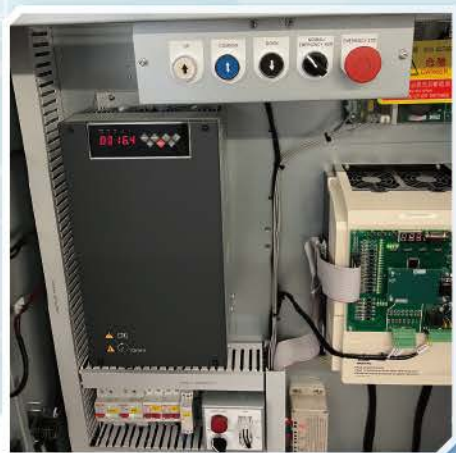
升降機的變壓變頻驅動器
