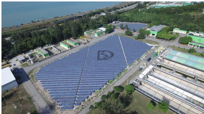
小濠灣污水處理廠太陽能發電場 A區及B區
