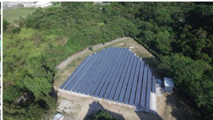
小濠灣污水處理廠太陽能發電場 C區
