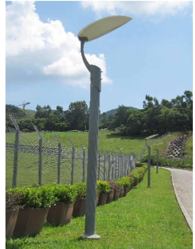
將軍澳第一期堆填區的道路照明系統
