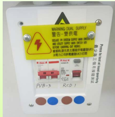
故障電流保護設備
