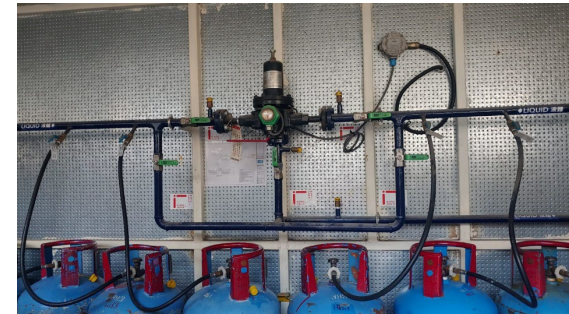
自動轉換裝置及管道系統
