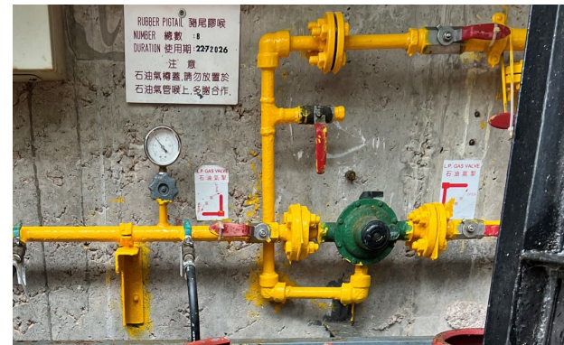
自動轉換裝置及管道系統
