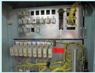
在控制櫃內裝設障礙開關掣
