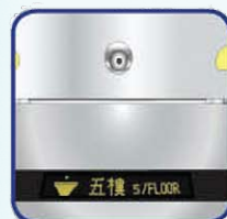
5. 加裝對講機及閉路電視系統
