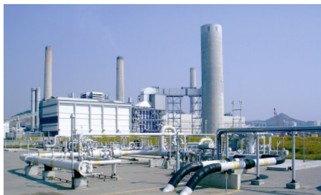
香港南丫發電廠天然氣接收站
