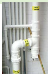
圖一：上給供氣分喉之直段喉管
