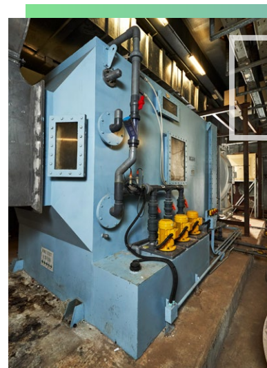
機房的布局設計應留有充足的空間作為各種機器項目的安裝、操作及維修之用
