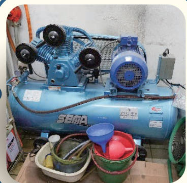
空气压缩机（风泵）
