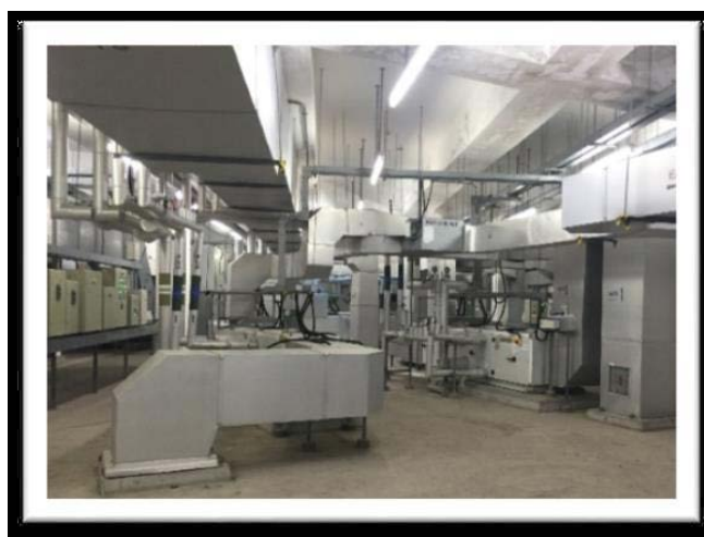
照片 A.8 空气处理装置
