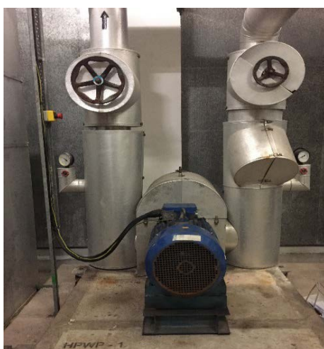
照片 A.11 冷冻水泵
