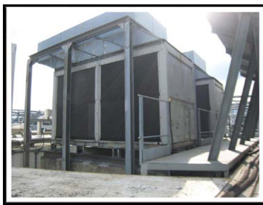
照片 A.10 风冷式冷水机组
