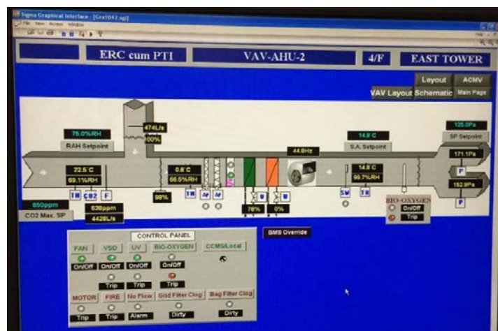
照片 A.9 空气处理装置中央控制及监控系统接口
