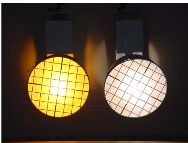
图 3: 东启德室内运动场现有高强度放电灯及高位照明器
