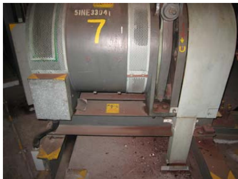
圖 3 - 機房內升降機發動機沒有發現損壞。
