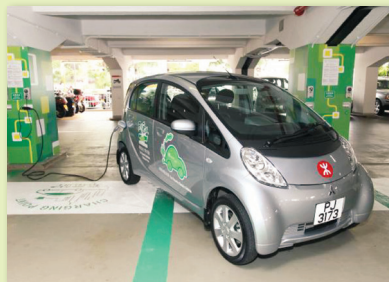
場內設有由本署安裝的標準充電站
