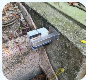
物聯網防洪監察裝置的安裝照片
