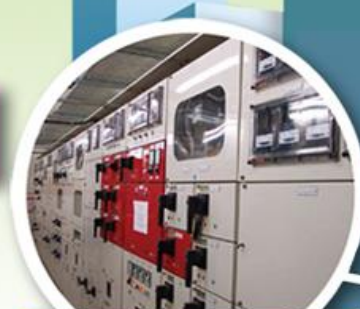
電力裝置 Electrical installation
