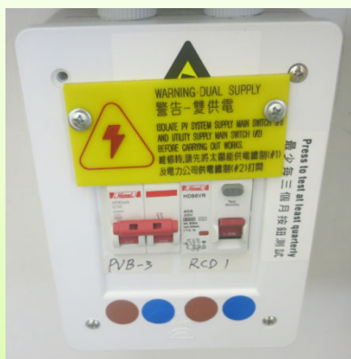
故障電流保護設備
