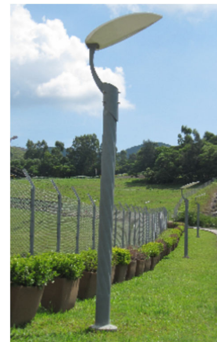
將軍澳第一期堆填區的道路照明系統
