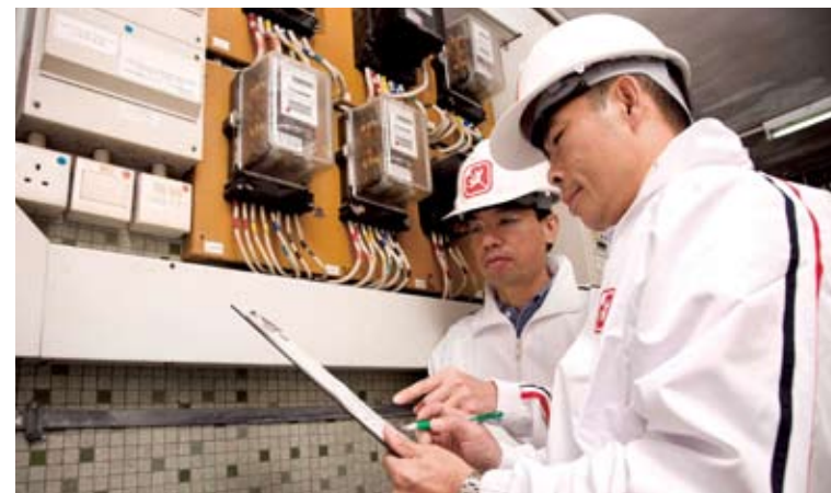
定期巡查大廈的固定電力裝置，是我們督察級員工的重要工作。
