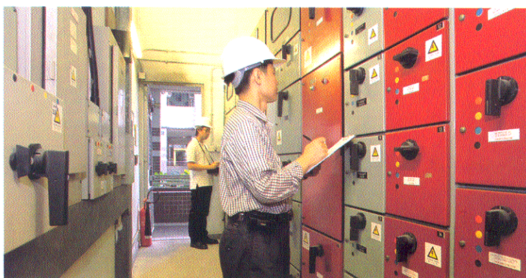
為住宅樓宇電力裝置進行定期安全測試是機電工程署優先處理的範疇
