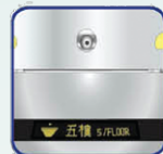
5. 加裝對講機及閉路電視系統
