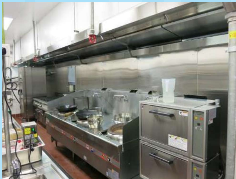
廚房內的氣體裝置
