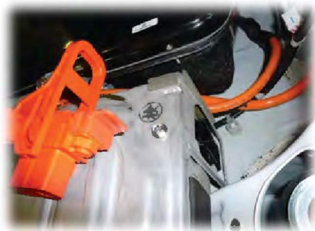
維修斷路器已拔開
