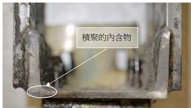
圖 2：左 U 槽立柱的斷裂表層
