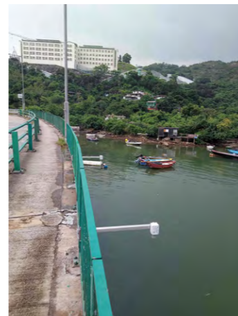
安裝在大欖涌聯安新村的 LoRa 水位傳感器 LoRa Water Level Sensor Installation at Luen On Sun Tsuen in Tai Lam Chung
