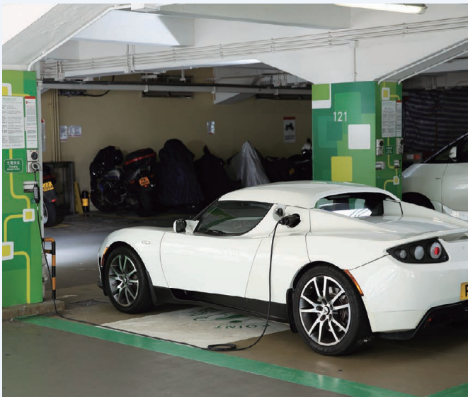
中環某政府停車場的中速充電器。 A medium-speed charging point in a government car park in Central.
