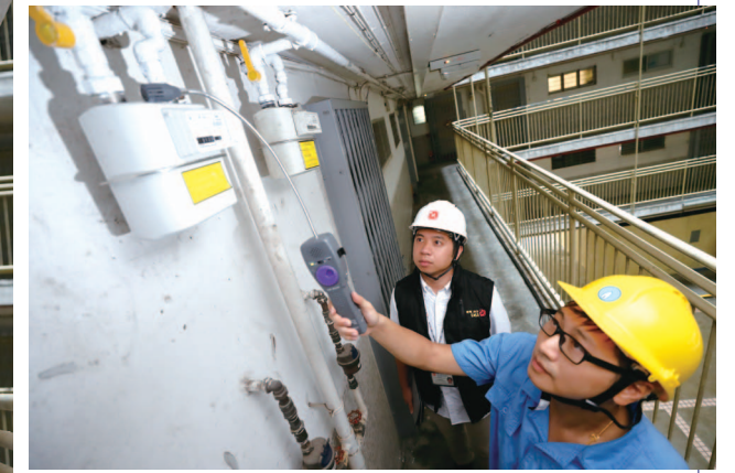
檢查煤氣錶狀況，是定期安全檢查的工作之一，以確保公眾氣體安全。
