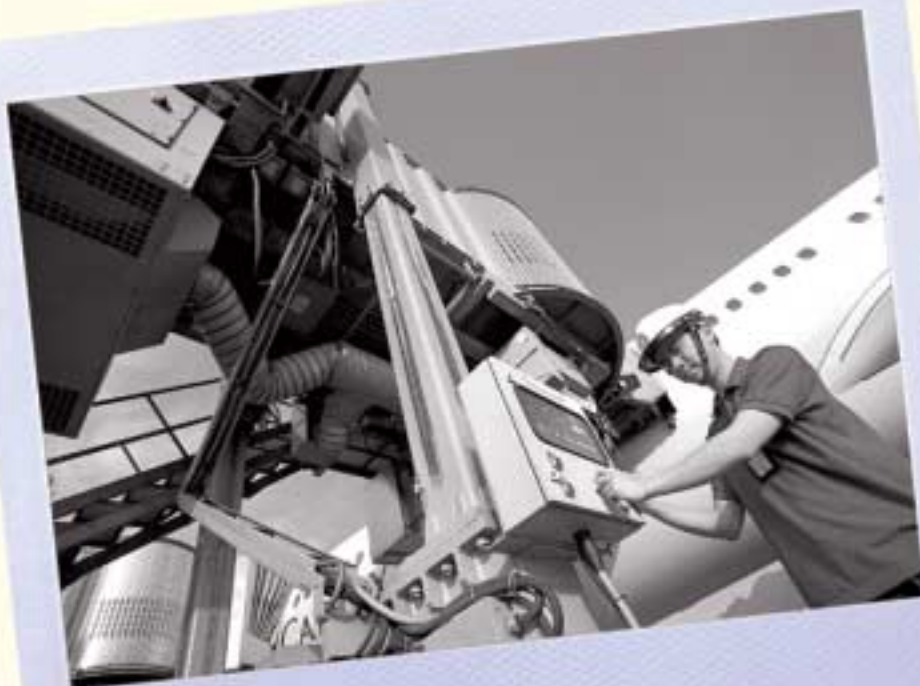
員工正操作地面固定電力系統的控制板。 Staff working on a Fixed Ground Power control panel.
